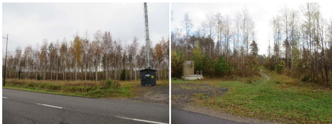
Kuva 14 a ja b. Ritaharjuntien varressa sen länsipuolella sijaitseva masto ja tien itäpuolella sijaitseva pumppuasema.
